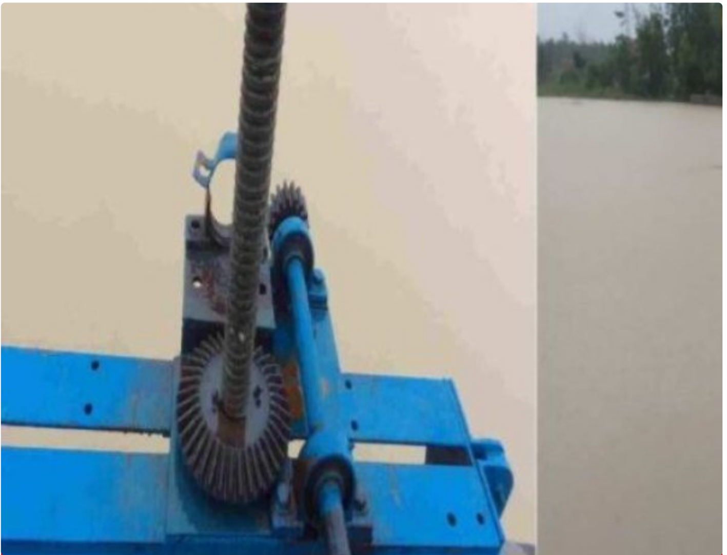
Pintu air Albaret Simpang Mesuji
